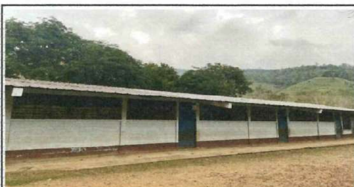
Foto 4: Se observa la falta de pintura en muros exteriores del establecimiento.
