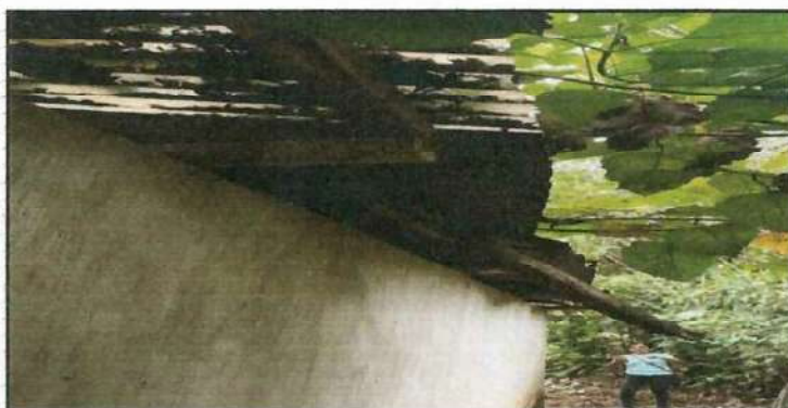
Foto 3: Se observa el daño e al techo de las otras aulas.
